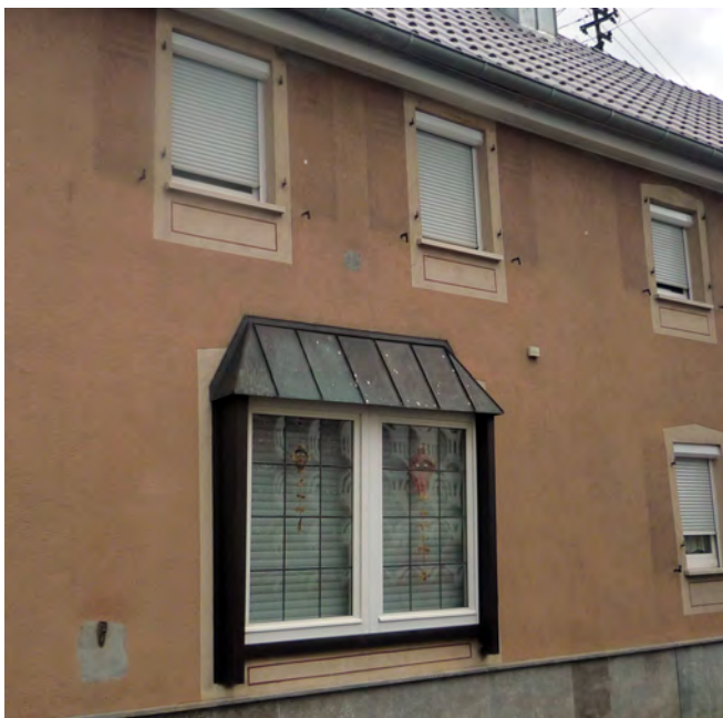
Negativbeispiel: unpassende Fenster, dünne aufgeklebte Sprossen, aufgesetzte Rollladenkästen
