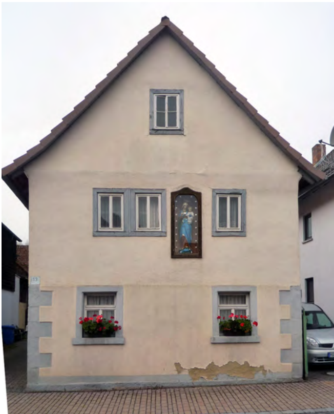
Bestand: Wohnhaus mit sanierungsbedürftiger Fassade
