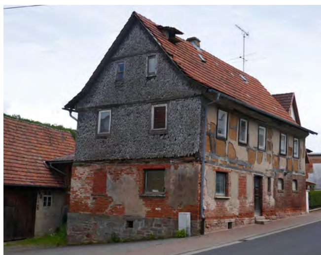
Historisches Gebäude mit Sanierungsbedarf
